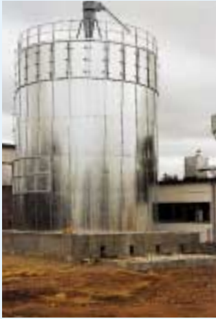
Isoleret 396 m 3 silo med indbygget fyringsanlæg.
