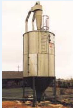
Silo med udmader og snegletransportør til fyringsanlæg.
