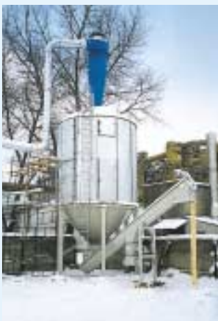
Silo med udmader for tømning i container.
